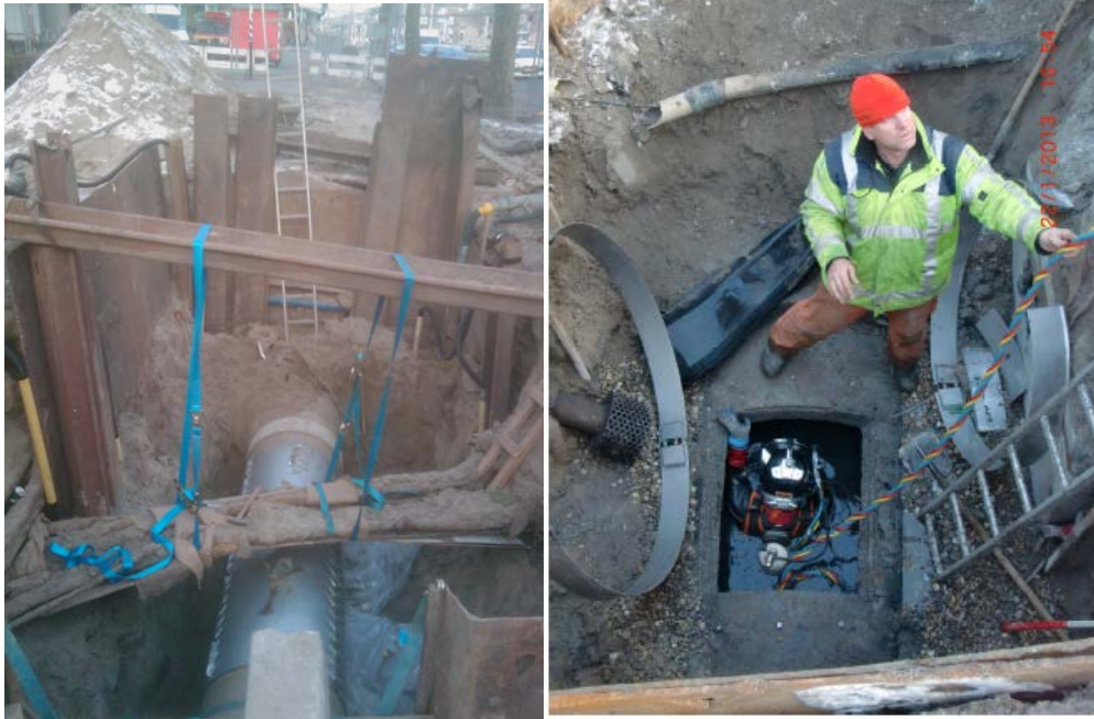
Figuur 5.2 Kosten calamiteit: gemiddeld € 100.000 in combinatie met beperkte/gecompliceerde omleidingsmogelijkheden afvalwater bij 'too big too fail'-leidingen. Op de linkerfoto staat een gerepareerde persleiding, op de rechterfoto is een duiker doende met onderzoek ter voorbereiding van een reparatie.
